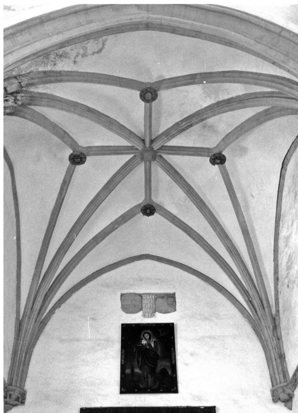
Figura 2. Bóveda estrellada gótica en la capilla mayor de la antigua iglesia del monasterio de San Francisco, h. 1505
