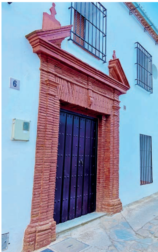
Figura 6. Cartajima. Calle Ronda, n.º 6. Edificio dieciochesco que muestra la bonanza económica del valle en el siglo XVIII. Fotografía de Ángela Pérez Navarrete
