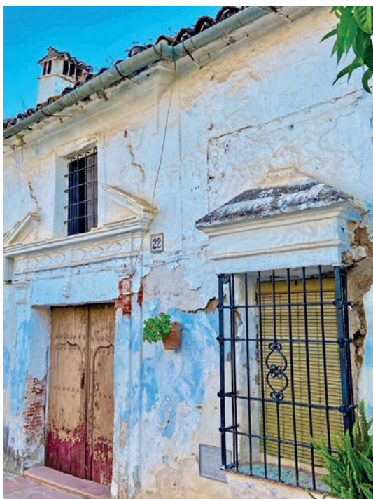
Figura 7. Cartajima. Calle Ancha n.º 22. Edificio dieciochesco, uno de los que se pueden considerar más desarrollados dentro de los ejemplos conservados. Fotografía de Ángela Pérez Navarrete
