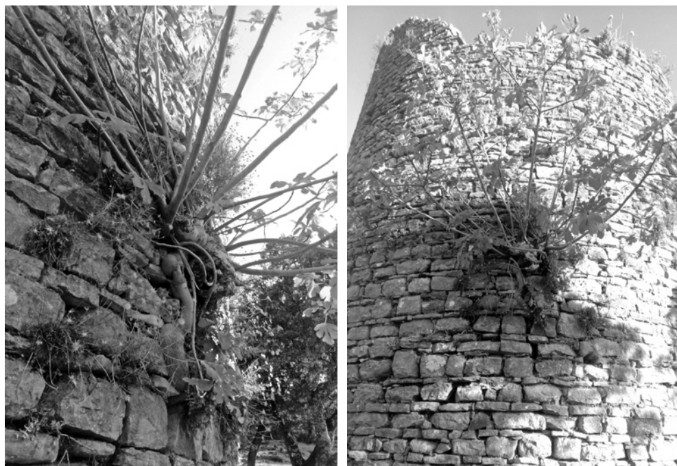
Figura 9. Higueras que han crecido entre los muros de la Torre
