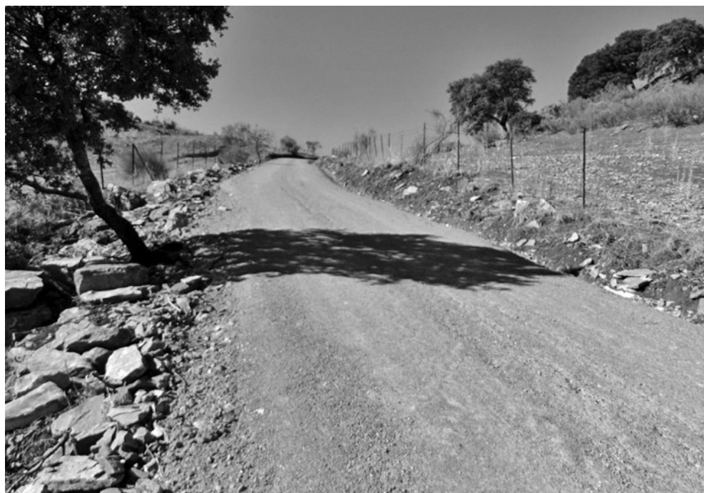
Figura 3. Estado actual del antiguo camino de Benaoján, una vez desaparecido el empedrado
